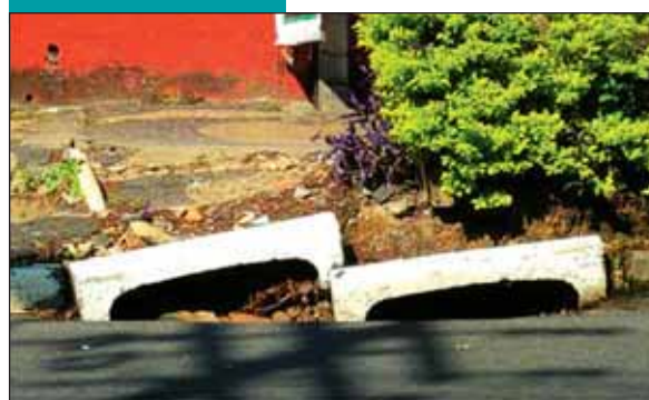
Boca-de-lobo destruída pelas raízes da árvore.
