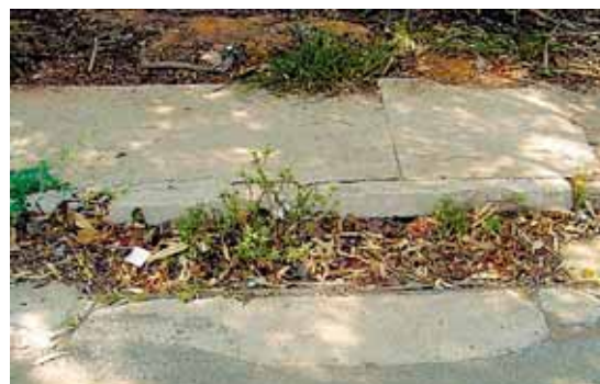
(b) bocas-de-lobo completamente obstruídas pelo lixo, e argamassa de concreto.
