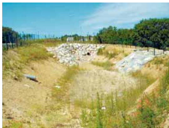
Reservatório de retenção para armazenamento da água escoada devido ao aumento da superfície asfaltada em uma rodovia
