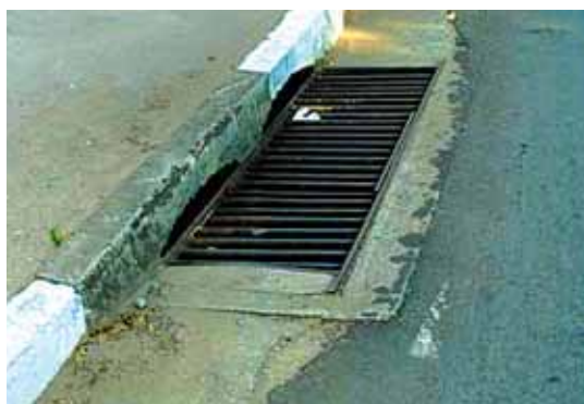
Típica boca-de-lobo combinada com grelha de barras transversais.
