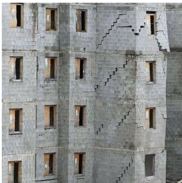
Figura 7 – Imagem das rachaduras do Prédio entregue aos moradores do Morro do Bumba
