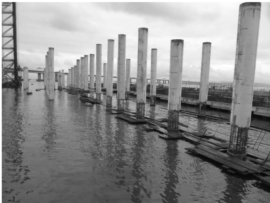
Figura 2.1-6: Exemplo de uma ampliação de cais de em laje de concreto armado sobre estacas. Fonte: CONCREMAT, (2014).
