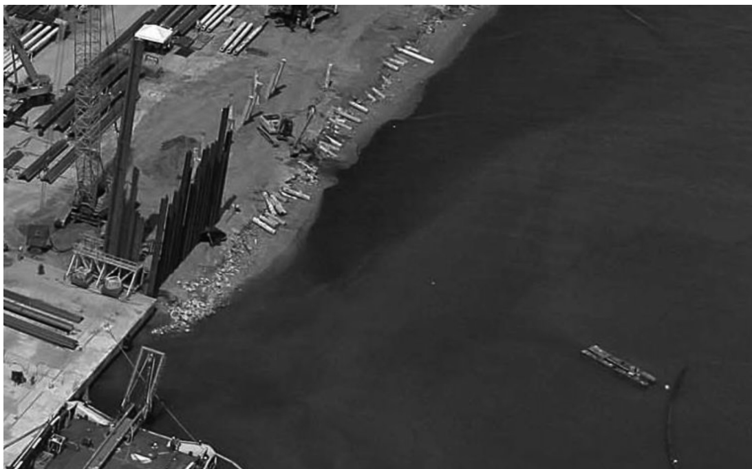
Figura 2.1-5: Exemplo de uma ampliação de cais com utilização de aterro. Fonte: CONCREMAT (2015).
