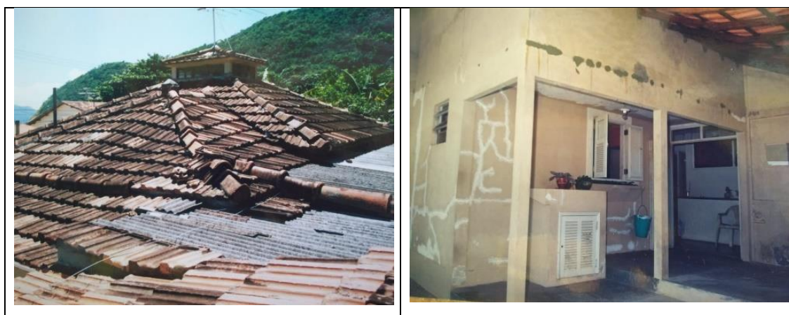
Figura 55: Estado geral da casa antes da reforma do telhado. Acervo familiar. 2000 (circa).
